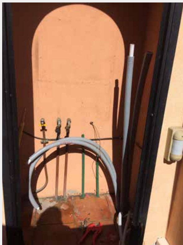
F - Foto del locale una volta dismesso il vecchio generatore
